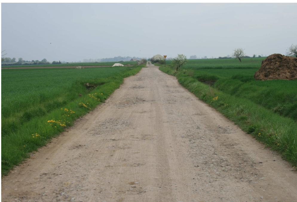
Zdjęcie nr 2 istniejąca droga gminna w obrębie km 1+600 – widoczne liczne ubytki w konstrukcji jezdni
